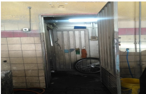
Foto No. 3. Cuarto de maquinas
